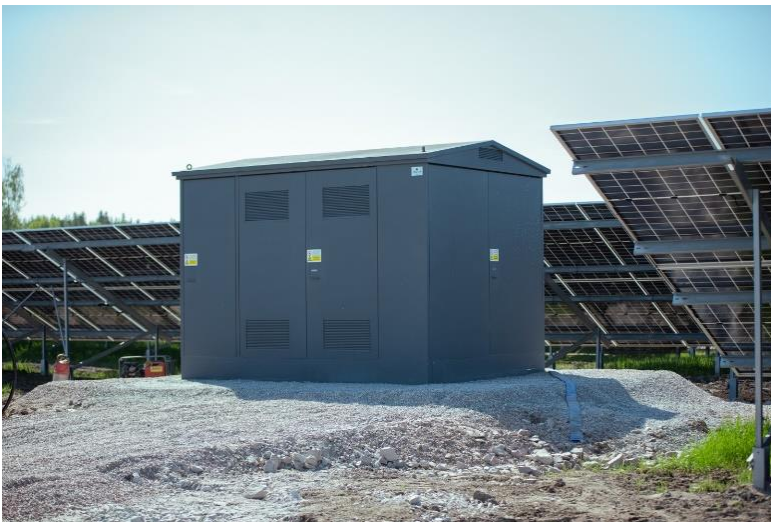
Kuva 6. Esimerkki muuntamosta, joka sijoitetaan aurinkopuistoon. Lähde: Helios Nordic Energy AB Kungsåra-aurinkopuisto.
